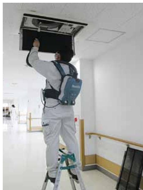
写真9. 院内エアコンの定期清掃
