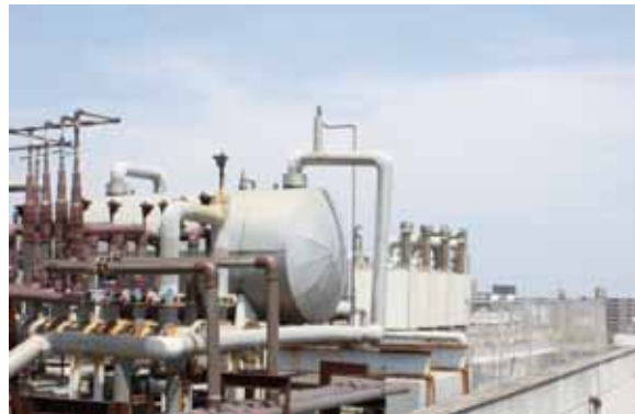
図7. 貯湯タンクとボイラー 水温は60℃以上に保つ必要がある
